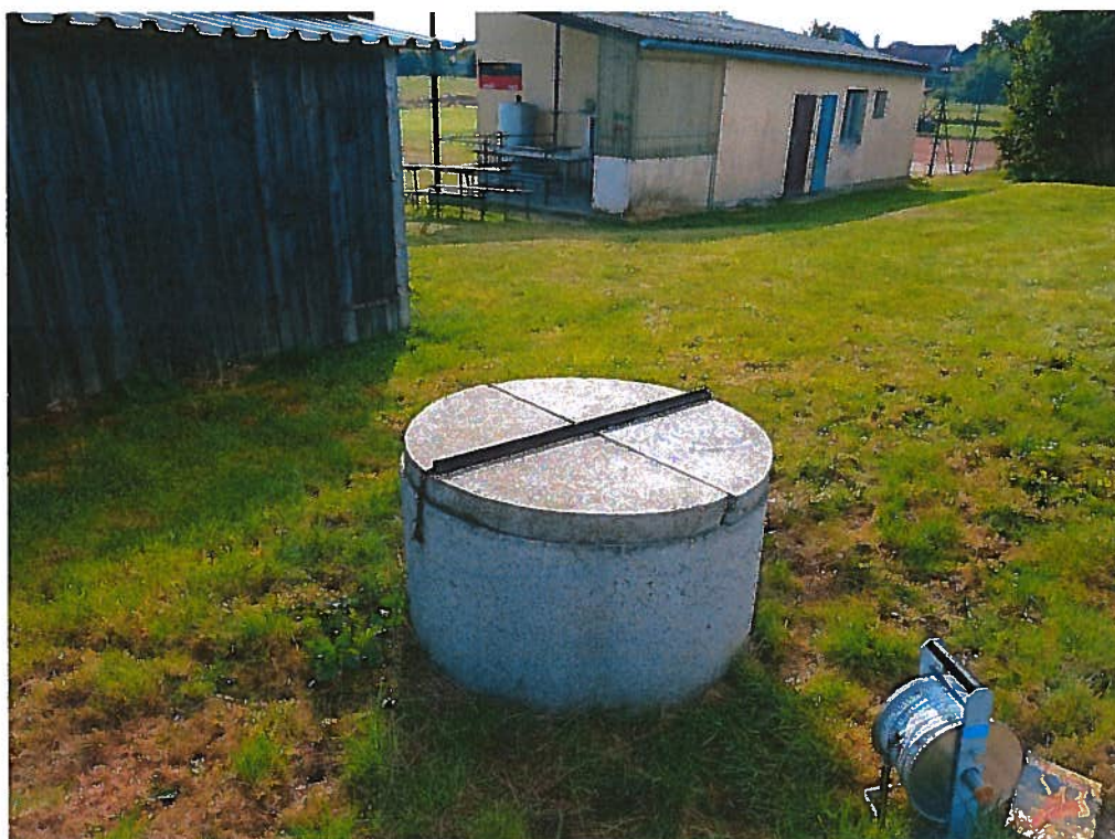
Foto č. 13: Stávající vrtaná studna V-1 u hřiště
