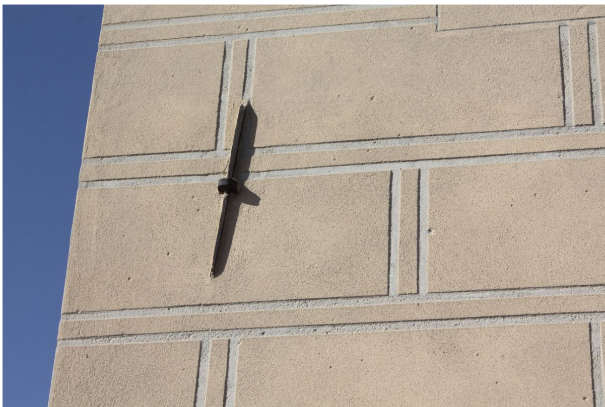
Obr. č. 28: detail lokálních poškození povrchu fasády po odprýsknutí povrchu a vytvoření malých důlků v omítce se sgrafitem
