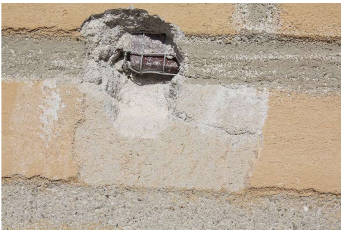
Obr. č. 14: detail stratigrafické sondy V1 pod korunní římsou, kde je zaomítaný železný prvek (armatura, táhlo?)
