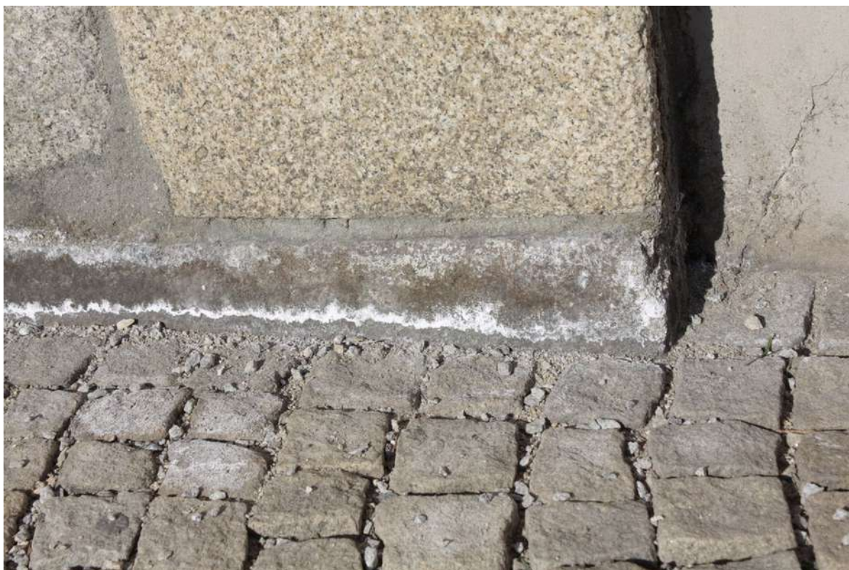
Obr. č. 10: detail poškození kamenného ostění krystalizací vodorozpustných solí
