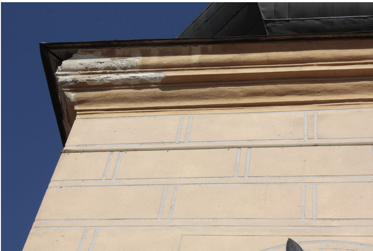
Obr. č. 44: detail poškození korunní římsy
