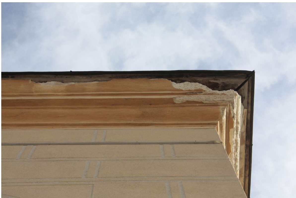
Obr. č. 62: detail poškození korunní římsy na západní fasádě věže
