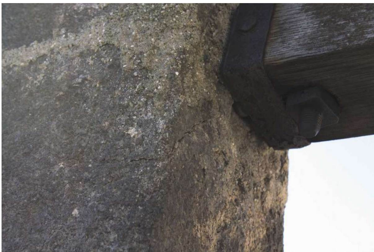
Obr. č. 31: detail praskliny pod uchycením konstrukce, závěsu zvonu
