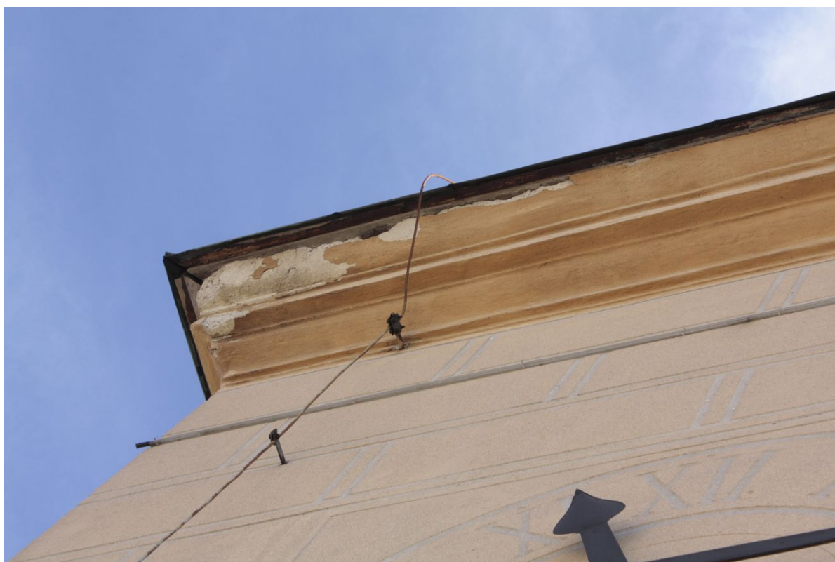
Obr. č. 61: detail poškození korunní římsy na západní fasádě věže
